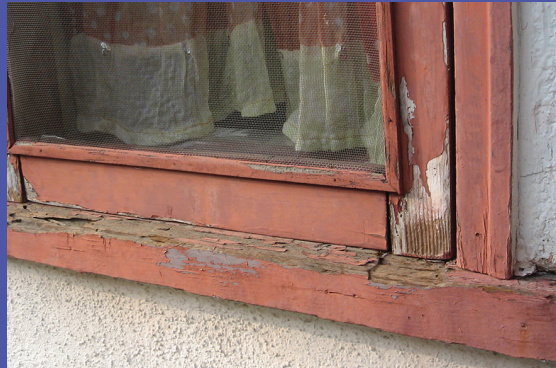
en pintura descarapelada
